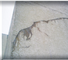
ผนังร้าว Cracked Wall
